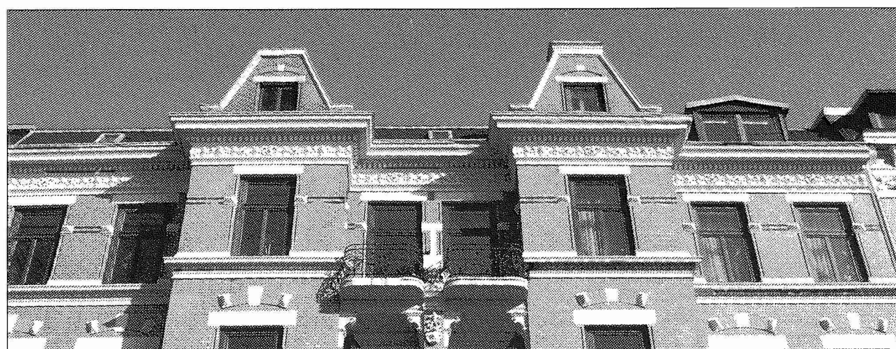
Vom Keller bis zum Dach: Gefahr durch Chlorprodukte lauert überall.
