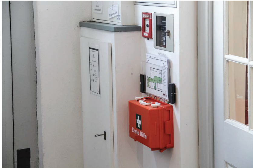
59 Schaltkasten, Rauchmelder und Steuerungsanlagen im Eingangsbereich des Handwerksmuseum Ovelgönne.
