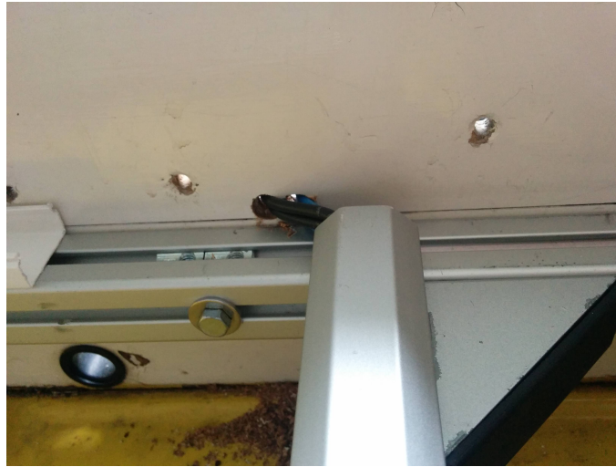
Abbildung 7.10: Kabelkanal zum Aluprofil
