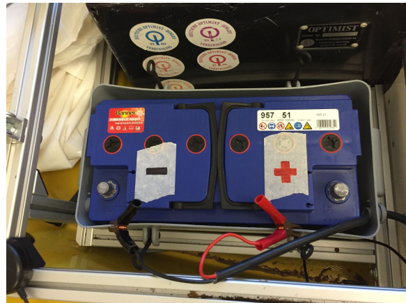
Abbildung A.8: In eine Otterbox eingebaute Batterie
