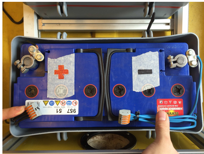
Abbildung 7.4: Verteilerklemmen zum Aufteilen des Batteriestroms
